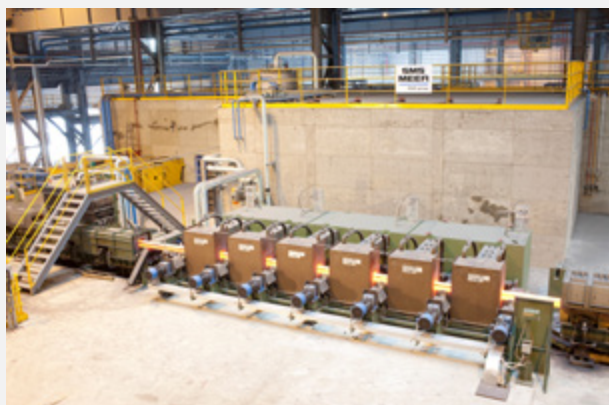
Bild 10: Induktive Erwärmanlage mit 6 Induktionsspulen bei Tung Ho Steel in Taiwan (Werksbild SMS Elotherm)
